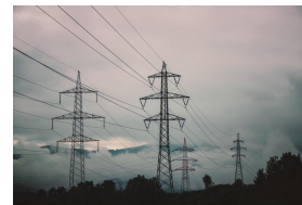
Torres de alta tensão
